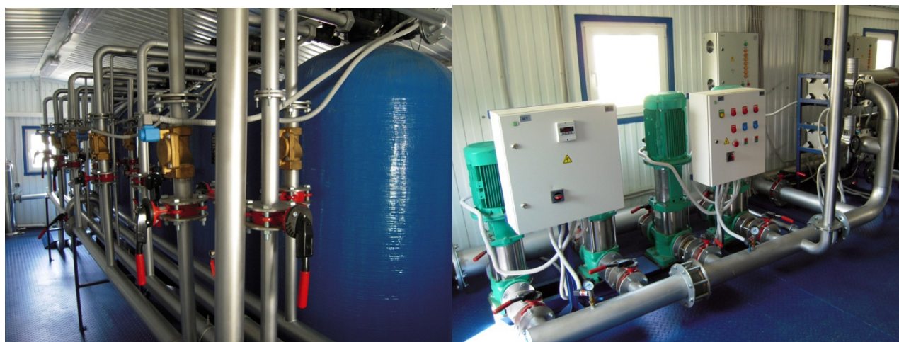
Рисунок 4.3 - Оборудование блочно-модульной станции водоподготовки
