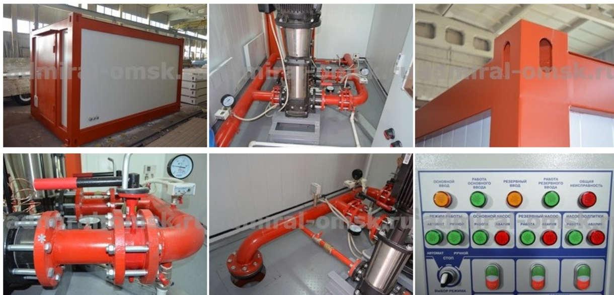
Рисунок 6.1 - Общий вид модульной насосной станции
