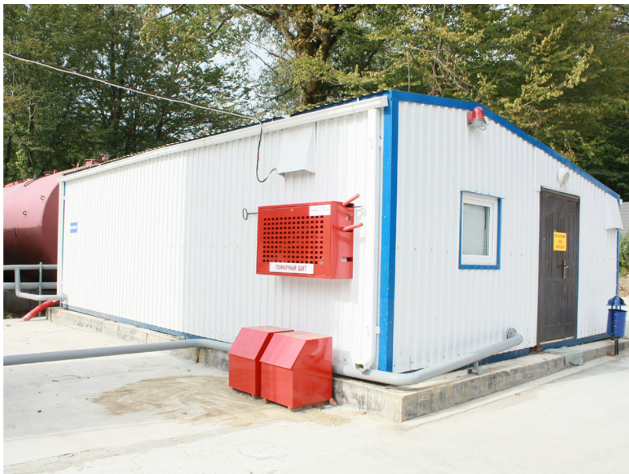
Рисунок 6.2 - Общий вид блочно-модульной станции водоподготовки
